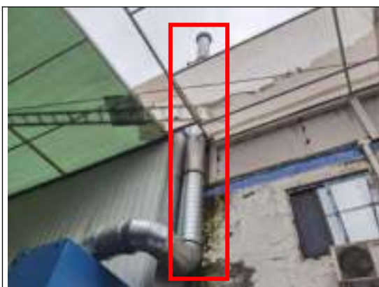
焊烟排气筒F1
