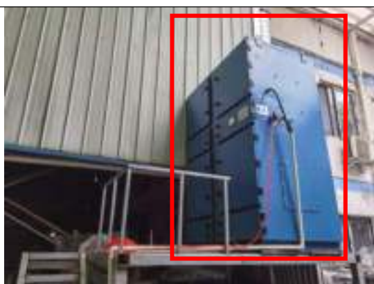
焊烟排气筒F1对应处理设备
