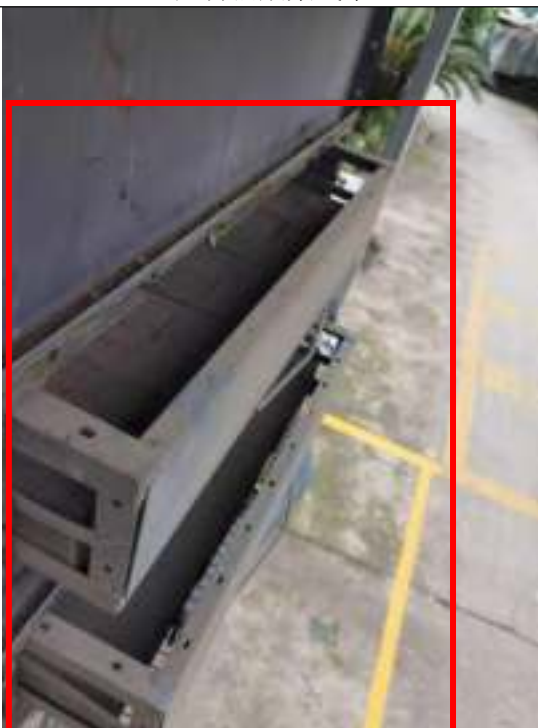
刷漆废气处理设施
