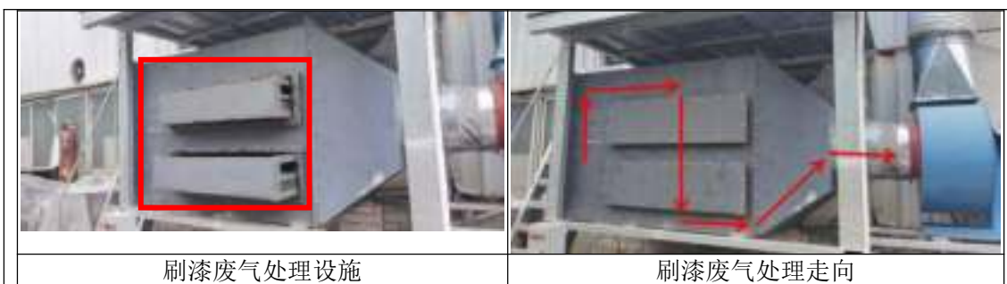
图 4-1 本项目废气处理设施图
