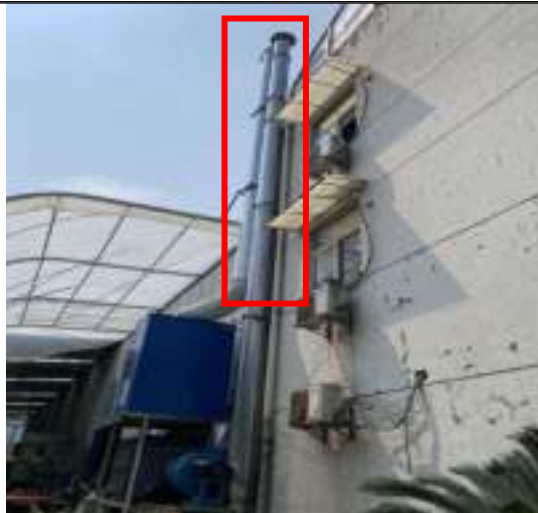
焊烟排气筒F2
