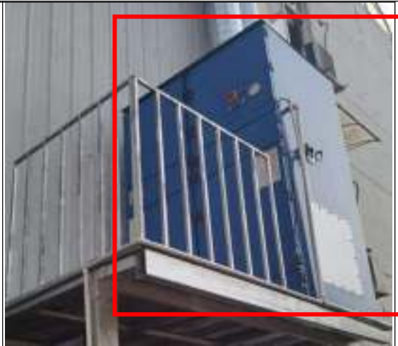
焊烟排气筒F2对应处理设备
