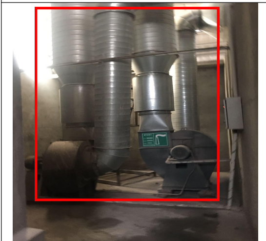
1#车间喷漆废气排气筒2#（合并为1根排放）
