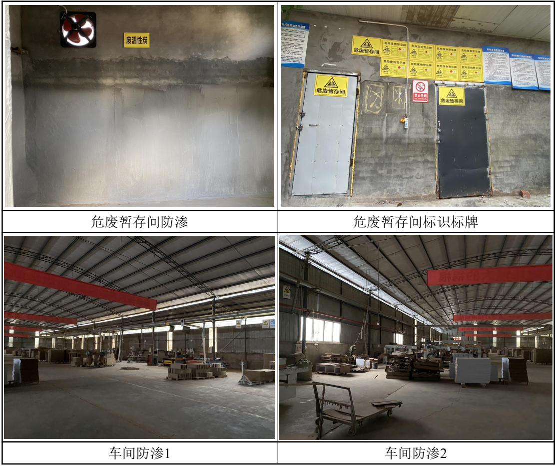
图 10-1 已采取的地下水防渗措施
