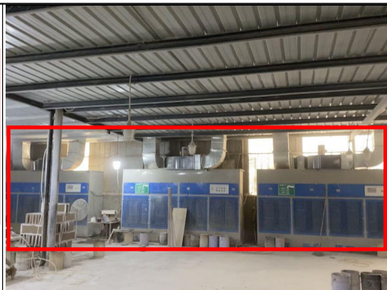
1#车间灰工粉尘废气处理设施
