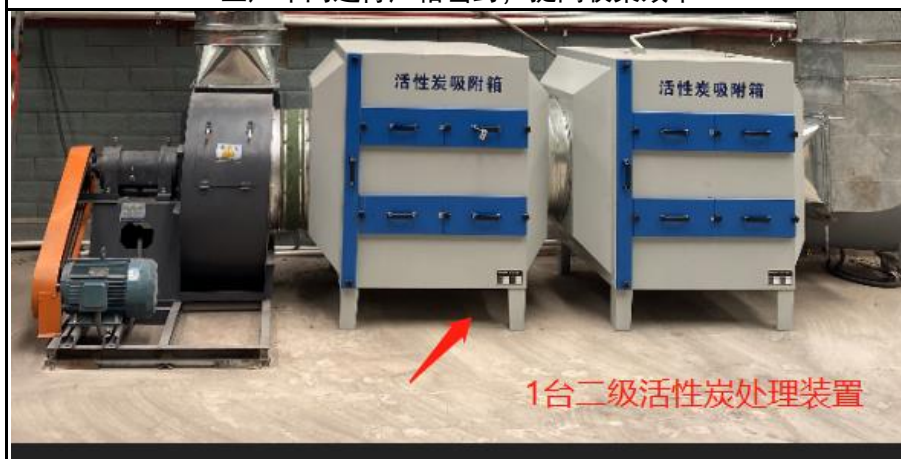
喷漆房两级活性炭处理装置
