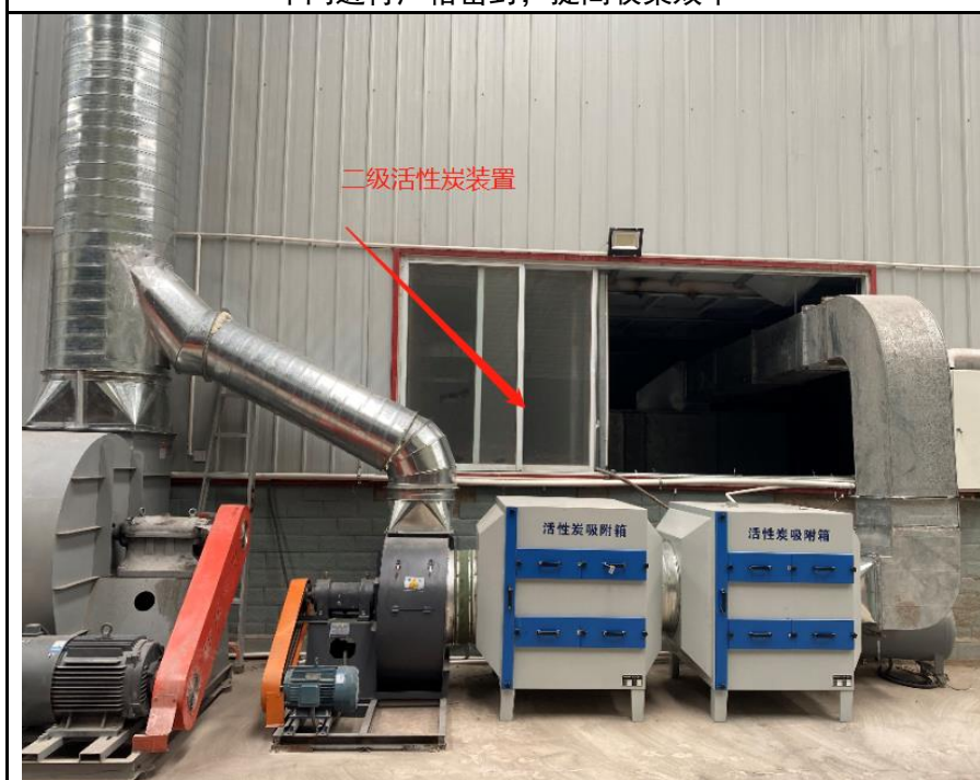
喷漆房两级活性炭处理装置
