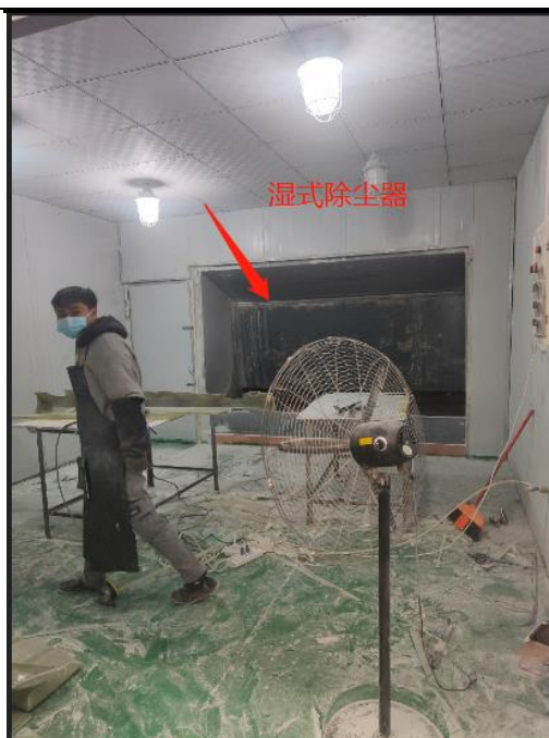
图 4-1 厂区已建的湿式除尘器
